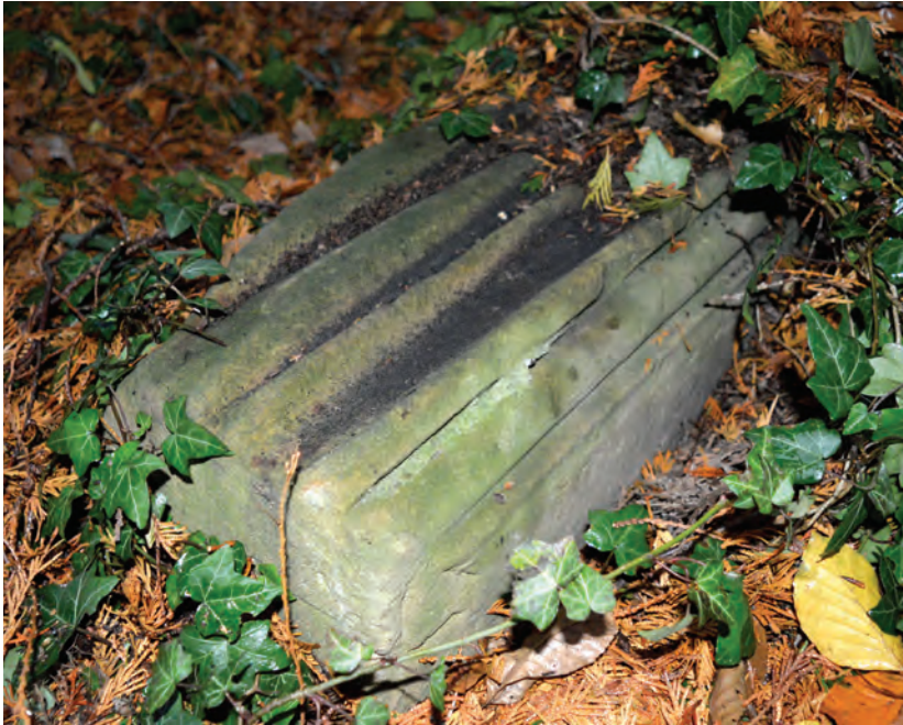
Il. 6. Fragment gzymsu wieńczącego, pochodzący z czasów XVI-wiecznej przebudowy, Zamek w Kórniku. Fot. Witold Miedziak
