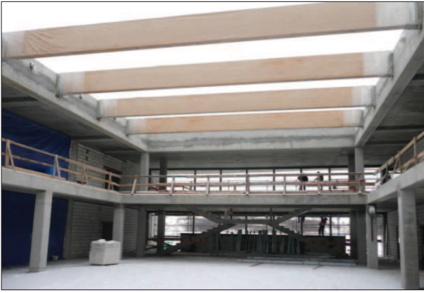
19. Czytelnia główna z widocznymi dźwigarami. Materiały z realizacji Biblioteki Głównej. PPiP 2010–2012 r. Fot. własne 19. The main reading room with visible beams. Materials concerning construction of the Main Library. PPiP 2010–2012. Private photo
