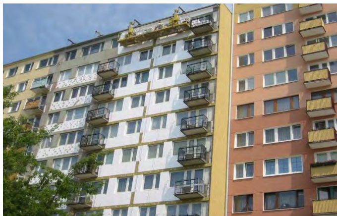
Ryc.2. System wielopłytkowy, ocieplenie wykonano bez oceny stanu technicznego wieszaków, budynek w I. etapie ocieplono – ściany szczytowe i filarki – metoda lekka-sucha, w II. etapie ocieplono: belko-ściany na fasadach i wymieniono ocieplenie na filarkach międzyokienne – metoda BSO (styropian); zachowano detal podziału elewacji na filarki międzyokienne i belko-ściany); stan w 2003 roku
