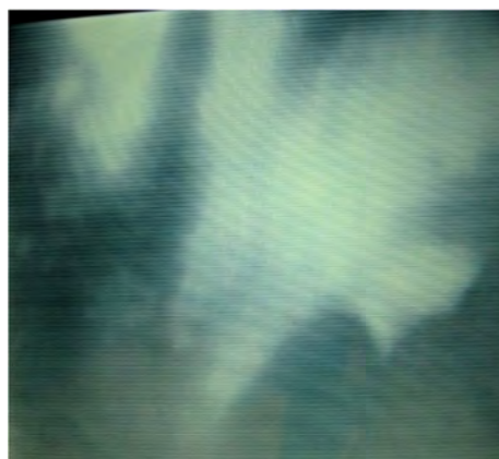
Ryc. 8 Widoczne zakłócenia drożności przewodu wentylacji na poziomie VII. kondygnacji, podgląd kamerą wziernikową Monitor ORCUS Fig. 8. Disturbances in air flow in ventilation ducts, 7th floor; image by Monitor ORCUS inspection camera
