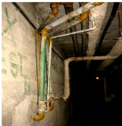
Ryc.9 Budynki prefabrykowane piwnice, stan instalacji c.w.u. i c.o.
