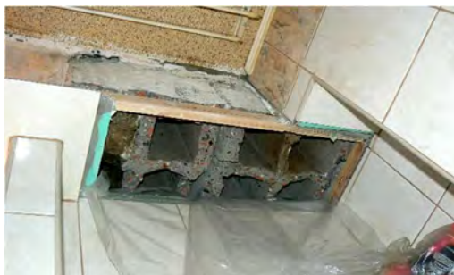
Ryc.6 Wentylacyjne kanały zbiorcze budynku prefabrykowany – samowolnie wyburzone Fig. 6. Common ventilation ducts - a precast ventilation block removed by the thoughtless flat owner
