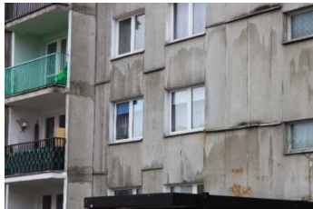
Ryc.17. Fragment budynku prefabrykowanego po I etapie ocieplenia. Zły stan płyt okładzinowych
