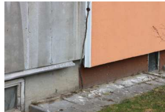
Ryc.18. Fragment budynku prefabrykowanego na styku I i II etapu ocieplenia. Zły stan płyt okładzinowych i stolarki okiennej, brak ocieplenia cokołu w obu etapach ocieplenia
