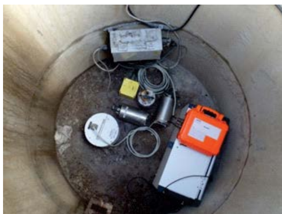
Rys. 3. Sposób instalacji aparatury pomiarowej
