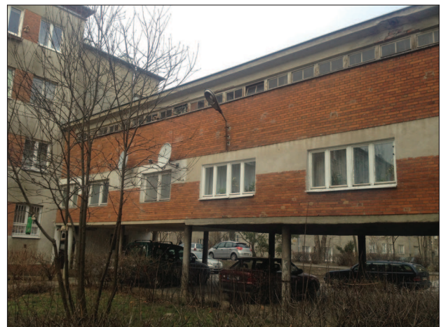
8. Wtórnie wybite otwory okienne w trakcie adaptacji łączników na mieszkania. Fot. K. Matysiak
