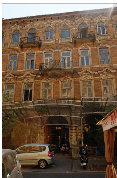
Fot. 6. Zdegradowane kamienice w ścisłym centrum Warszawy (ul. Foksal) Źródło: M. Stępnik (fot. 6, 7).
